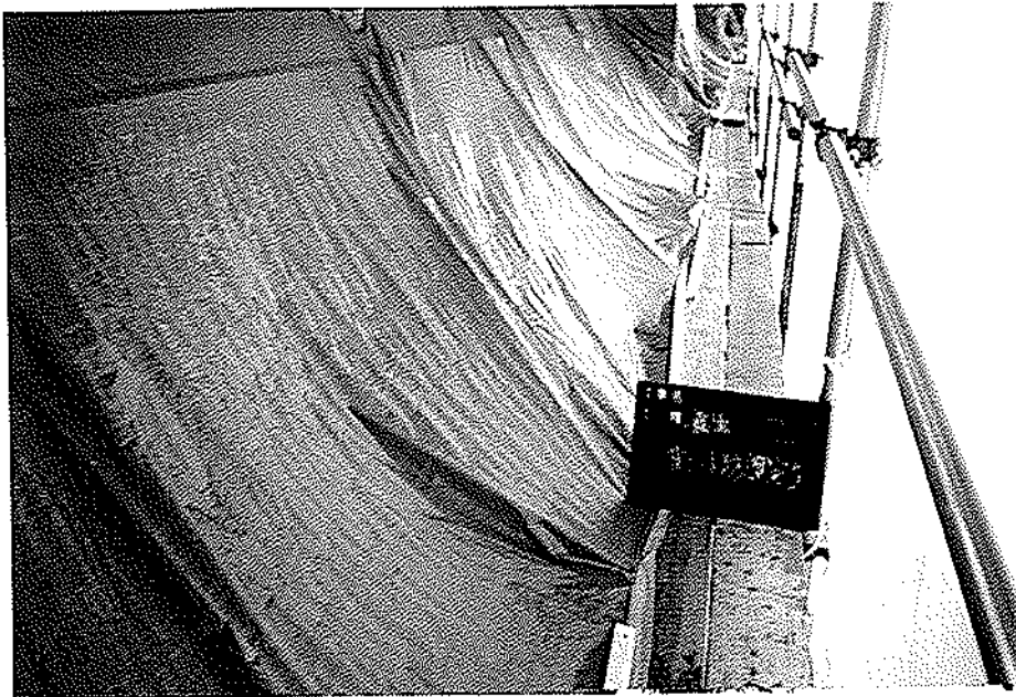
側面防護状況
