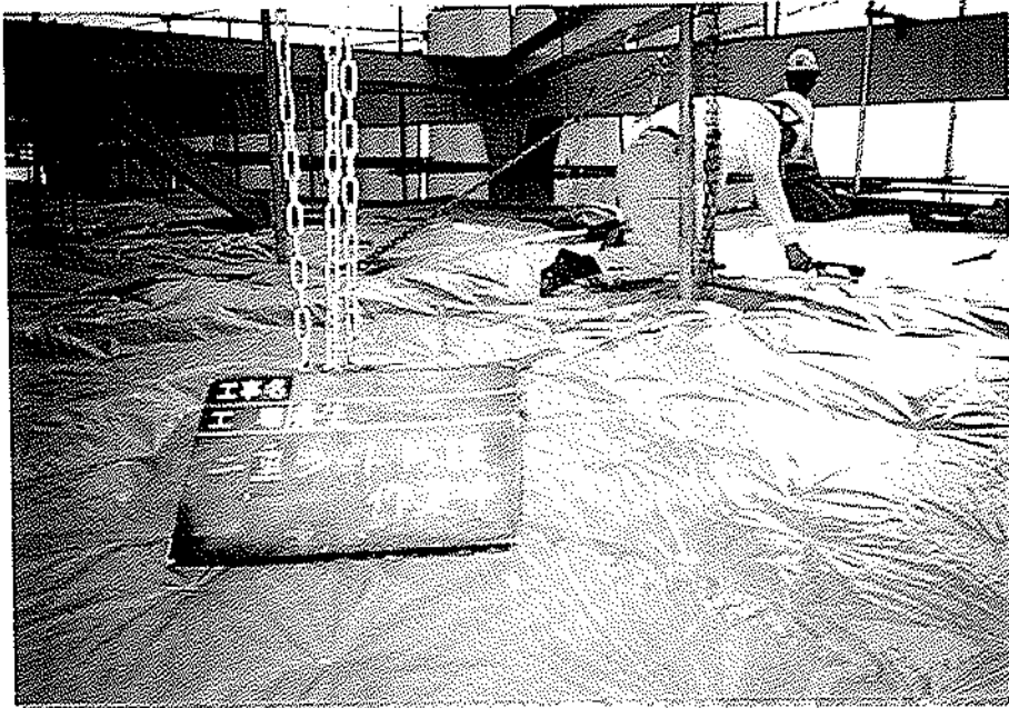
床面防護状況
