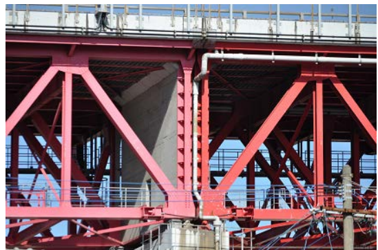
写真-14 同材齢の塗装変状例
