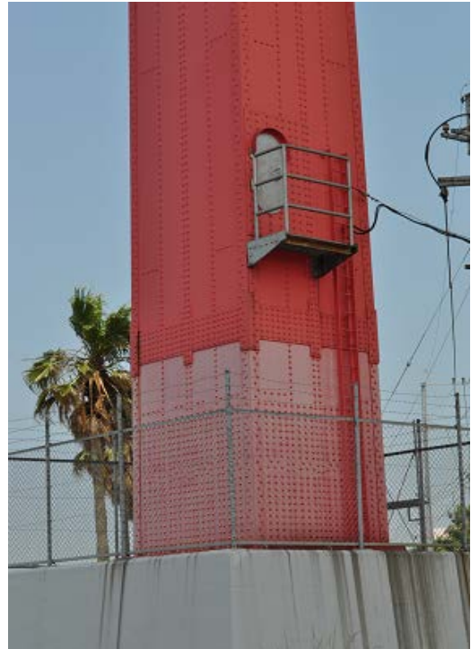
写真-13 呷素塗装の変状
