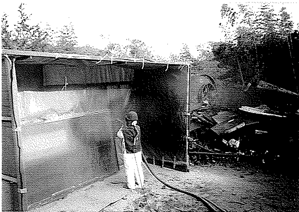
サンドによるモイスターブラスト 噴射水圧 : 0.6MPa 噴射水量 : 0.67L/分 ブラスト吐出圧力 : 0.5MPa ブラストノズル : 10mmφ
