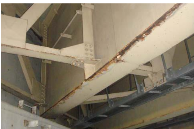
写真-1 一般塗装 (a-1 塗装系) の塗膜劣化 (一般環境、約 15 年経過)
