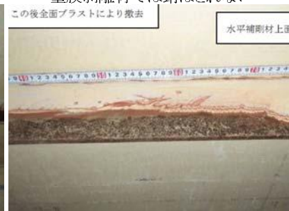
処理1日後 深く細かい錆が取りきれない 早期に再発錆(ターニング)
