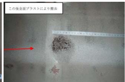
処理1日後(以前3種ケレンで処理箇所) 早期に再発錆(ターニング)
