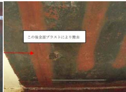
塗膜内の錆発生箇所 塗膜剥離材では錆はとれない
