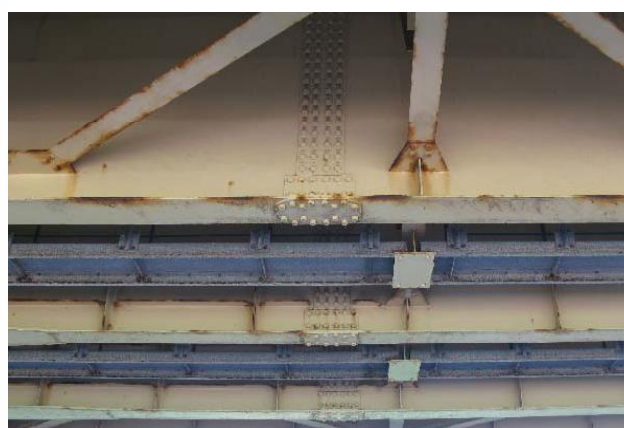
写真-4 塗替え塗装 (c-1 塗装系) の塗膜劣化 (やや厳しい環境、約 11 年経過)
