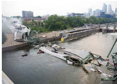
○崩壊後の橋梁
