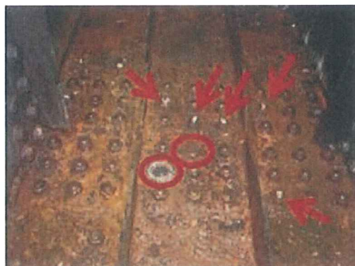
写真-3. 5 ボルト脱落状況 ○：脱落 ←：亀裂
