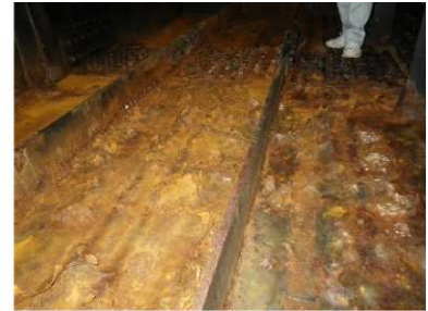
写真-12 箱桁内部の腐食
