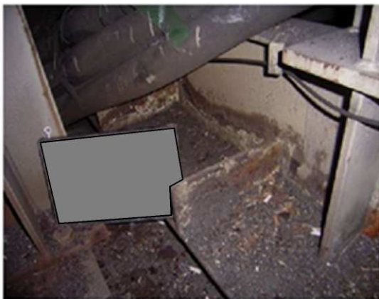
写真-1 腐食損傷状況
