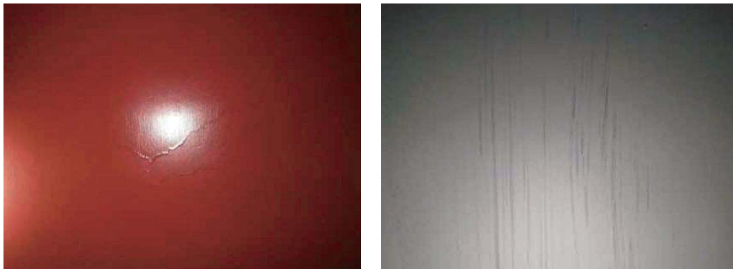
写真-2 仕上がり不良状況 (左:下塗リスプレーのたれ 右:中塗りはけの仕上がり低下)
