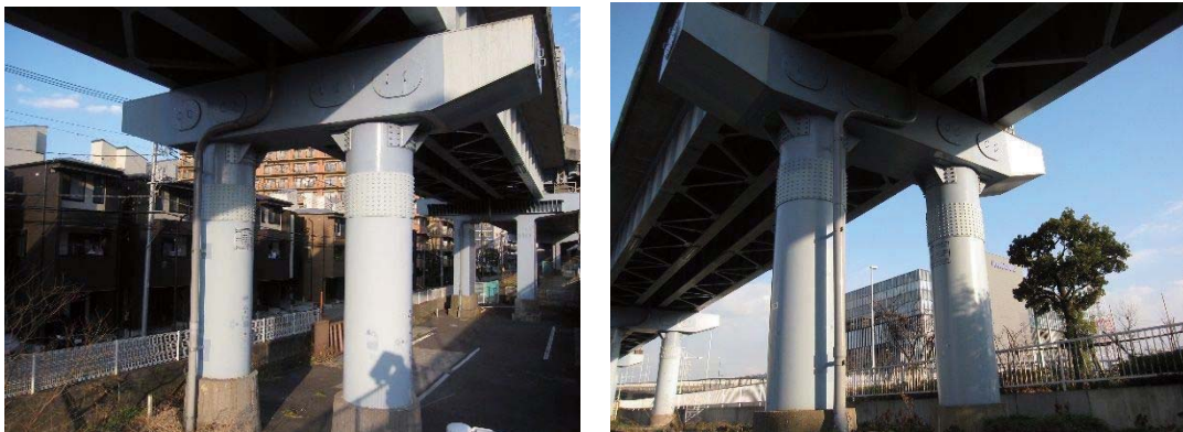
写真-1 新砂町高架橋の橋脚（平成 29 年 3 月撮影）左：下塗りから水性仕様 右：中塗りから水性仕様
