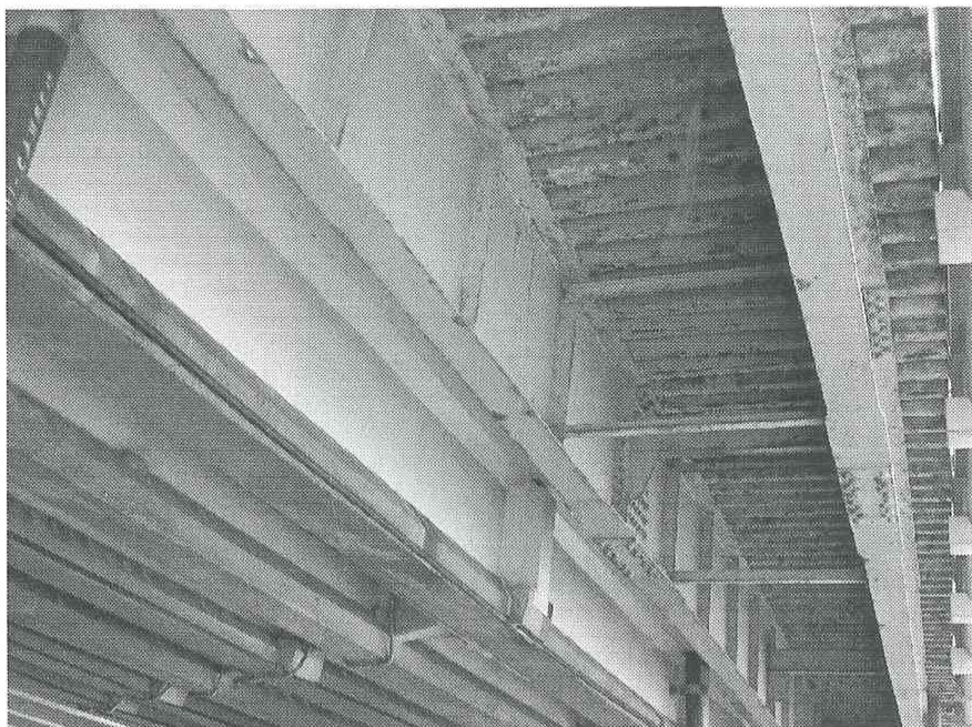
写真－２ 無機系塗料を塗装後数年で部材端部が発錆した側道橋 (東北地方)
