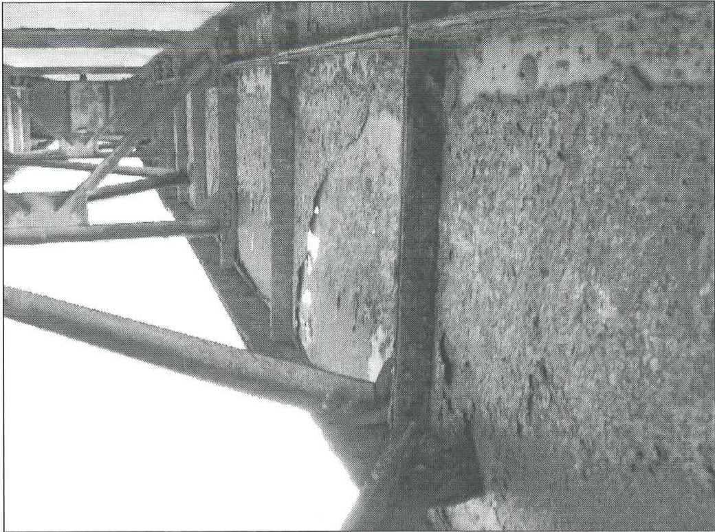
写真一3 (3) 桁内面の腹板（山側）の腐食
