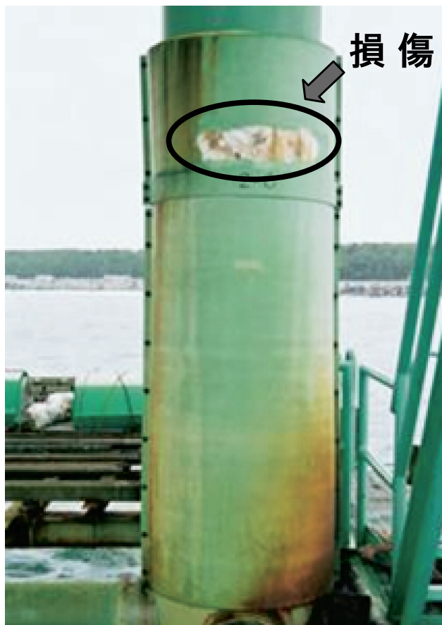
写真-7 FRP保護カバーが損傷した例
