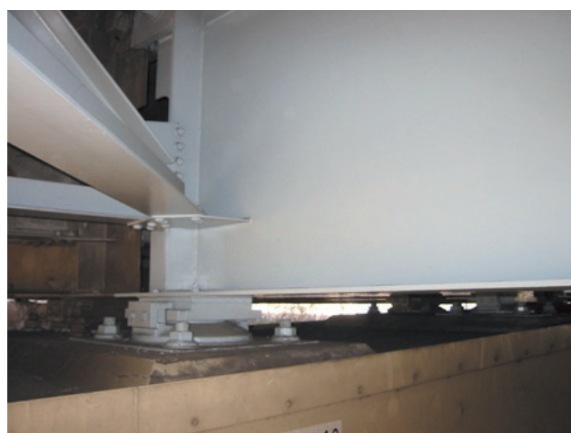
写真-3 施工15ヶ月後の状況（支承近傍）
