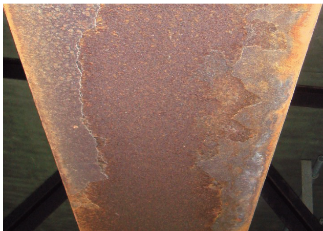
写真-2 下フランジ下面のさび層のはく離跡
