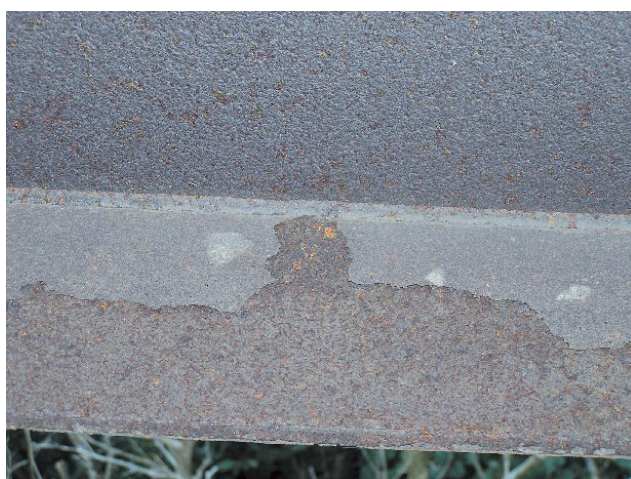
写真-3 下フランジ上面のさび層のはく離跡
