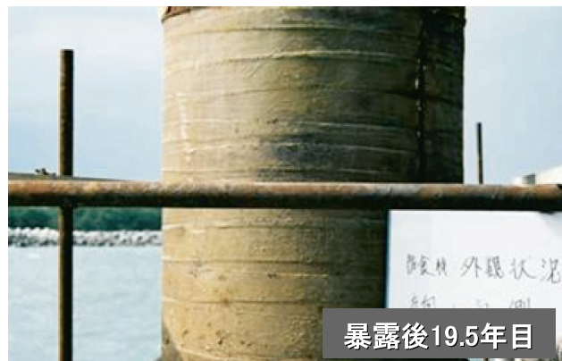
写真-8 (1) ペトロラタム系防食材の外観 (FRP保護カバーを外した状態)
