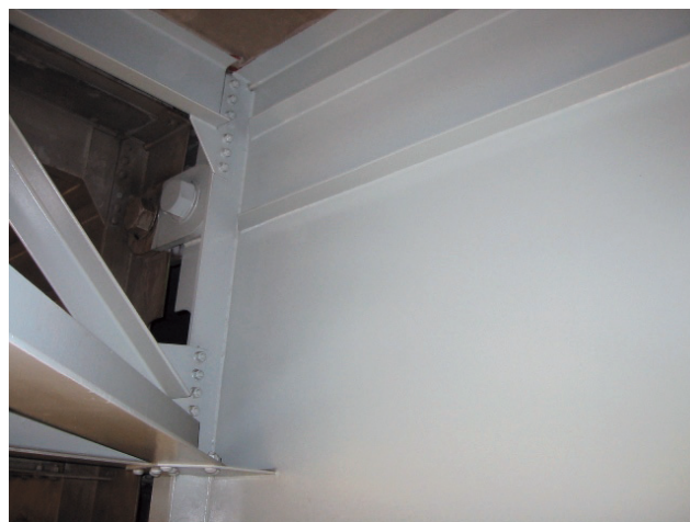
写真-2 施工15ヶ月後の状況（桁端部）
