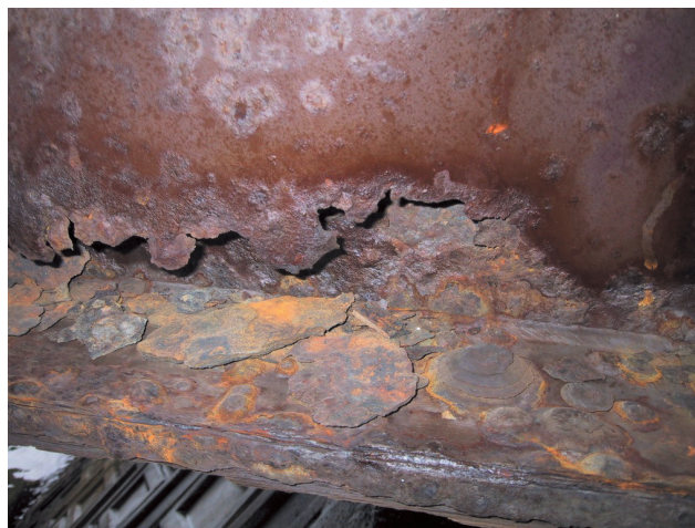
写真-1 腹板および下フランジ部の層状さび
