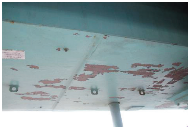
写真-1 MIO/中塗間の層間におけるはがれの例
