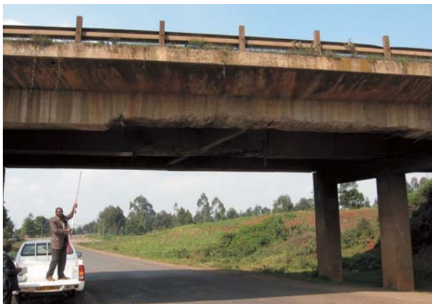
引張鉄筋の破断したRC橋
