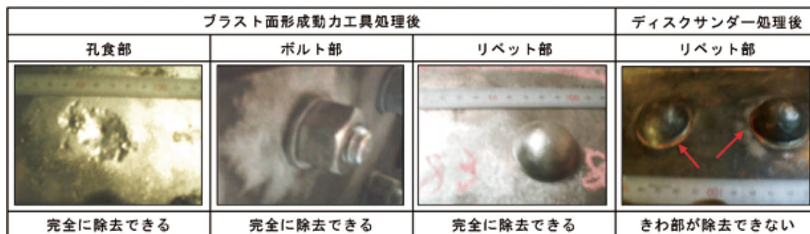
写真-10 孔食部、ボルト、リベットでの処理事例
