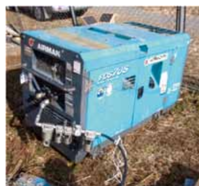
写真-2 コンプレッサー
