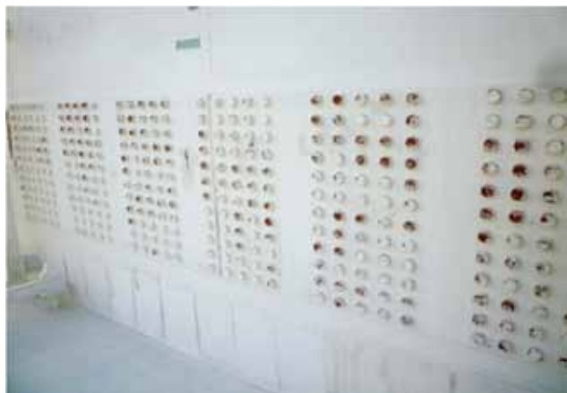
写真-3 塗膜劣化状況（ボルト部）
