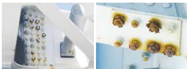
写真-1 高力ボルト継手部の腐食
