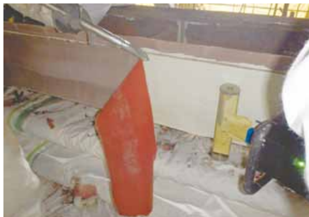
写真-5 補剛桁塗装剥離状況 2
