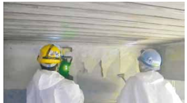
写真-3 横桁部塗装剥離状況
