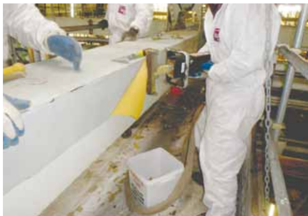
写真-4 補剛桁塗装剥離状況 1
