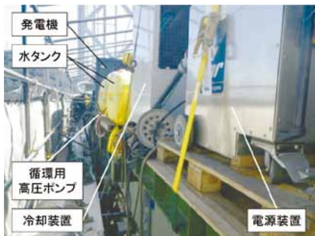
奥から発電機（400V, 100kVA）、 水タンク（循環用高圧ポンプ）、冷却装置
