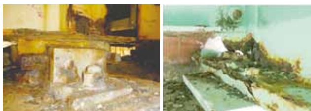
写真-2 桁端部の腐食
