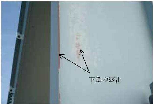
写真-1 上塗り塗膜の塗膜損耗
