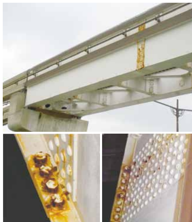
写真-3 モノレール鋼軌道桁の高力ボルト部の腐食
