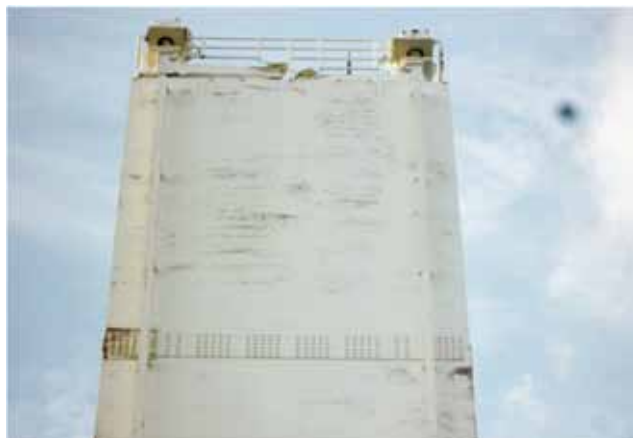
写真-2 塗膜劣化状況（主塔頂部付近）
