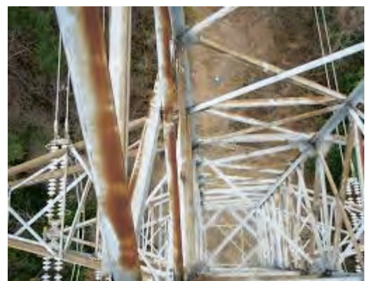
写真-6 さび発生した溶融亜鉛メッキ送電鉄塔
