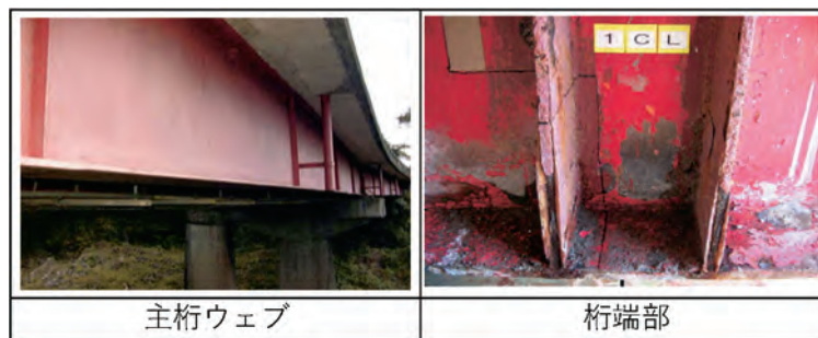
写真-1 同一橋梁における部位による腐食、塗膜劣化の違い
