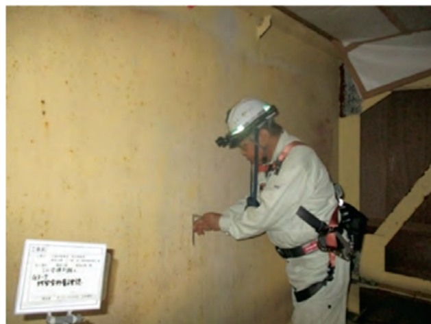
図-11 桁の曲がり確認状況写真
