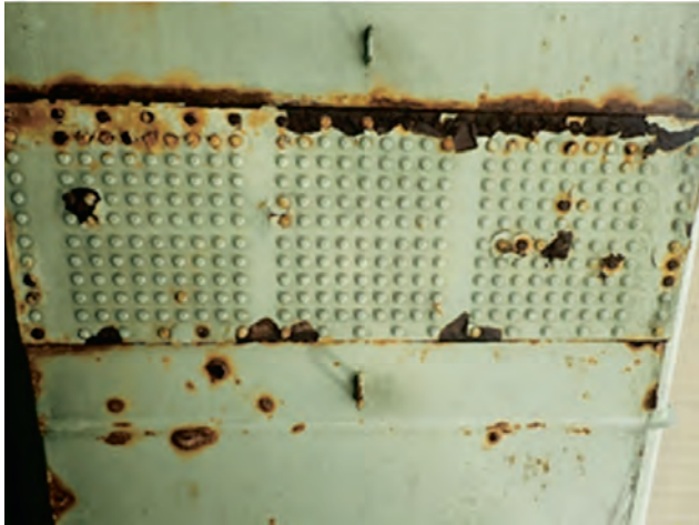
(a) 損傷状況①
