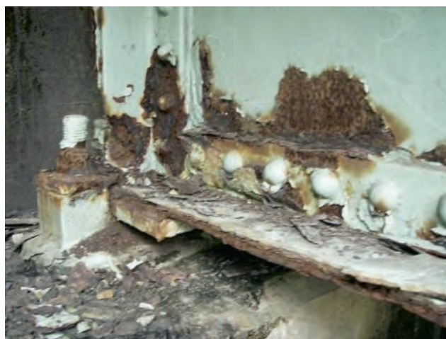
(a) 下フランジ上面の腐食
