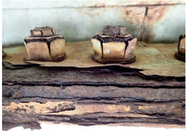
(b) 損傷状況②
