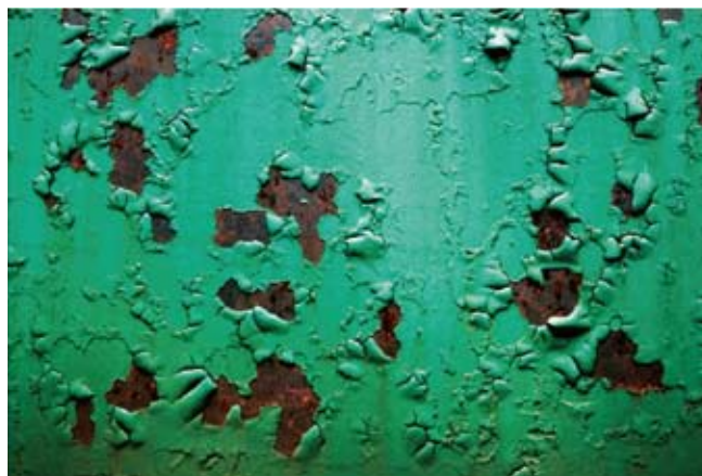
鋼素地からの剥がれ
