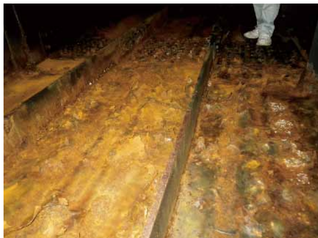
写真-12 箱桁内部の腐食
