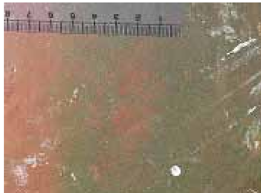
写真-7 処理前の塗膜状態
