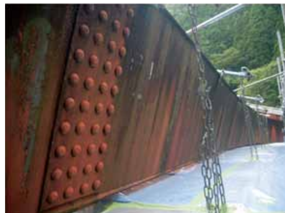
写真-2 塗替え前の腐食劣化状況
