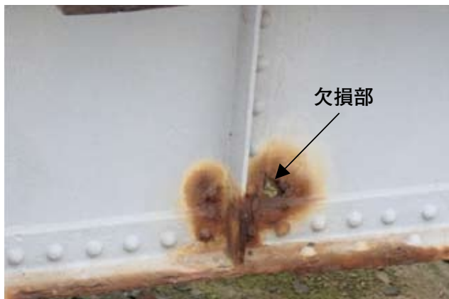
図-8 局所的な腐食により部材の欠損に至った事例
