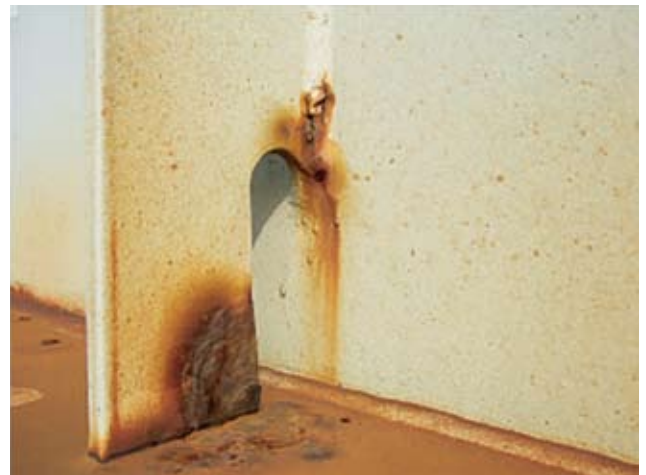
図-2 局所的な塗膜変状および腐食を生じた部材の例
