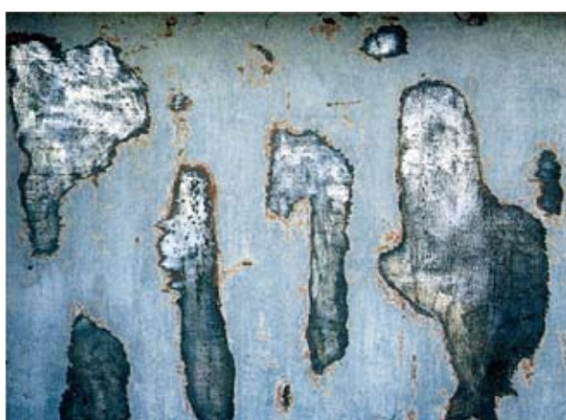
動力工具を用いて替ケレン-2を適用した状態であり、鋼素地露出箇所にさびは残存していない
