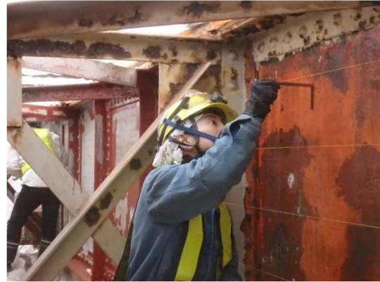
図 13 腹板の変形測定状況
