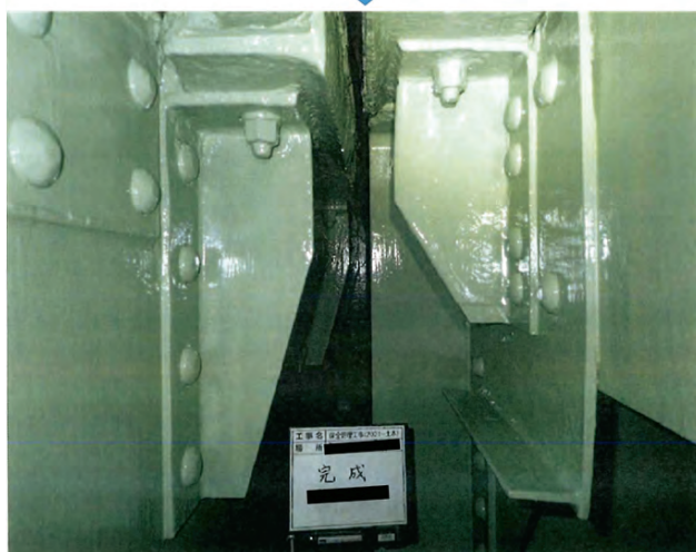
写真-7 水かかり部にある損傷の補修事例 (鋼桁端部のさび腐食損傷で判定レベルⅡ相当)
