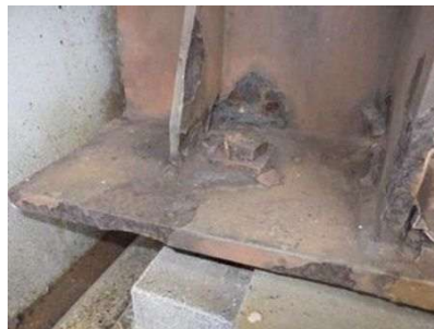
(a) 補修塗装後の再劣化
