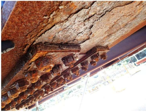
図 5 AWT で対象とした耐候性鋼の重度腐食部
