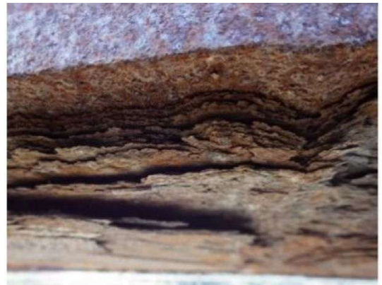
図 1 耐候性鋼材の異常さび
