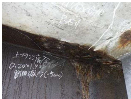
図 9 床版漏水により上フランジに発生した重度腐食
