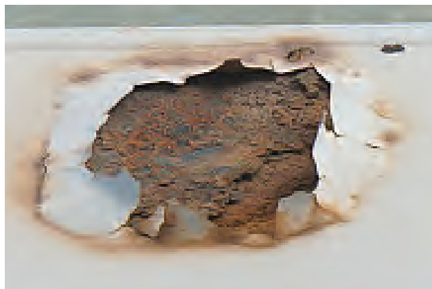
写真-9 円形の塗膜ふくれ
