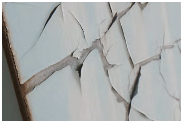
写真-5 塗膜の亀甲状割れ (拡大)
