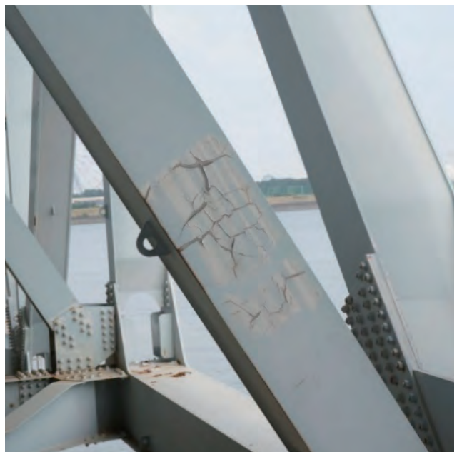
写真-25 凝集破壊による変状① (塗膜割れ)
