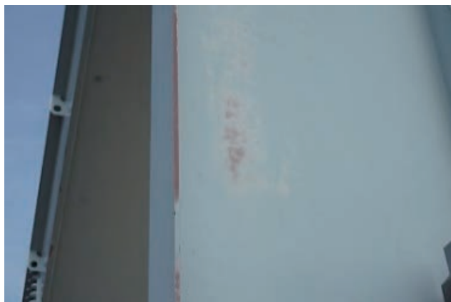
写真-2 上塗り塗膜の摩耗
