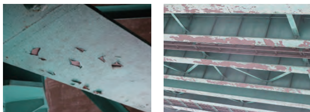
写真-1 福岡高速での塗膜剥離状況の一例
