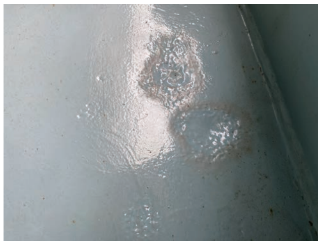
写真-28 経過観察結果（局部腐食箇所）
