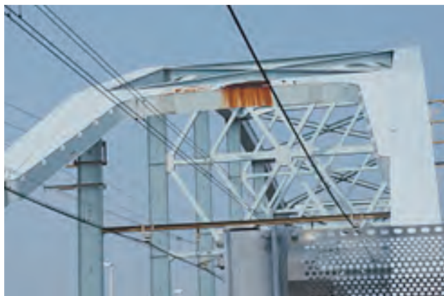
写真-6 凝集破壊による塗膜剥がれ (ランガーアーチ橋門構)
