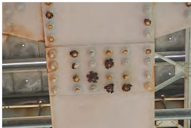
写真-3 ボルト・ナット部の腐食
