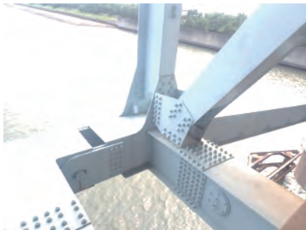
写真-29 経過観察結果（凝集破壊箇所）
