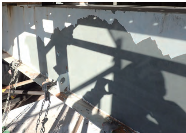
写真-26 凝集破壊による変状② (塗膜剥がれ)
