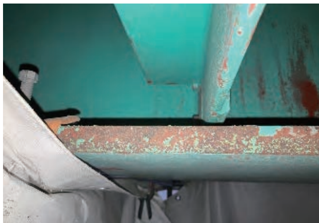
写真-18 部分的な発錆箇所
