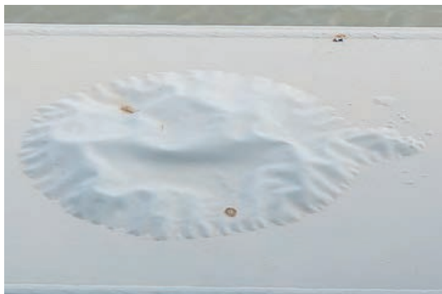
写真-8 円形の塗膜喪失
