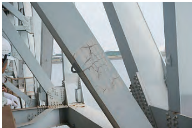
写真-4 塗膜の亀甲状割れ
